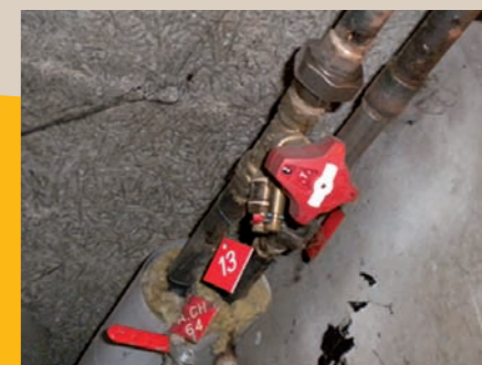
Vanne pied de colonne chauffage
