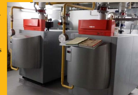
Chaufferie collective résidence Richard Mique
